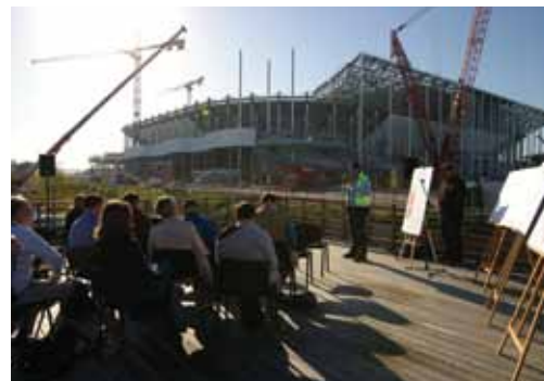
Conférence de presse du 9 avril – présentation de la charpente métallique du toit par David ROUXEL
